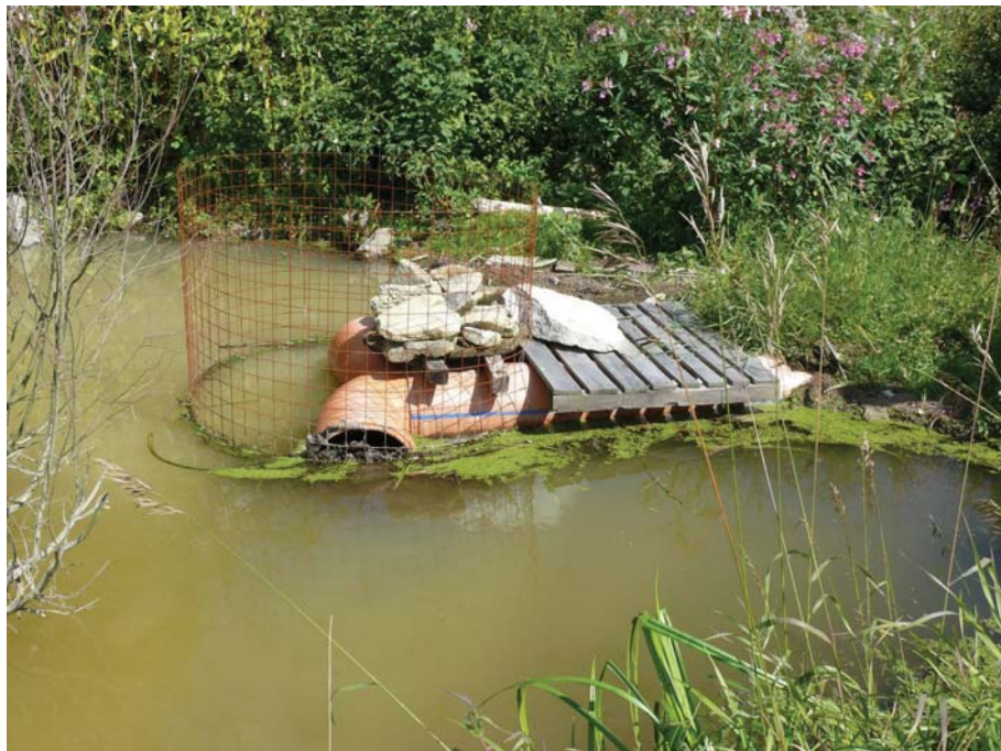
Abb. 10. Dammdrainage mit Regulierung der Einlaufhöhe durch drehbare Winkelrohre. Der Schutzkorb jedoch ist zu klein dimensioniert und zu nahe an den Rohren.
