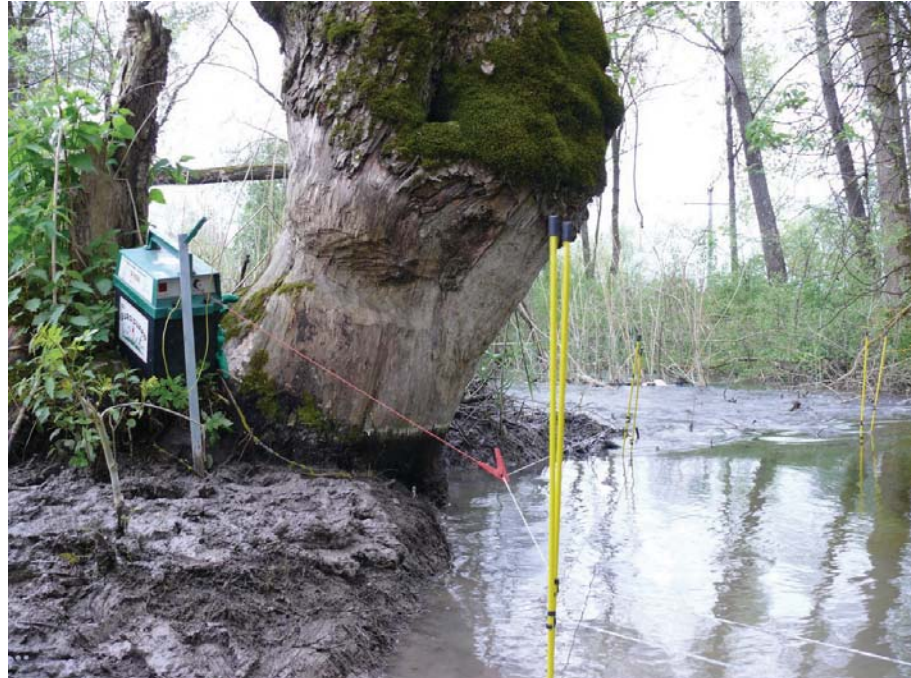
Abb. 6. Anschluss eines 12 V Akkugerätes an Zaun (rote Litze) und Erdpfahl (grüne Litze). Wegen des nassen Bodens funktioniert die Erdung auch mit wenig eingeschlagenem Erdpfahl.
