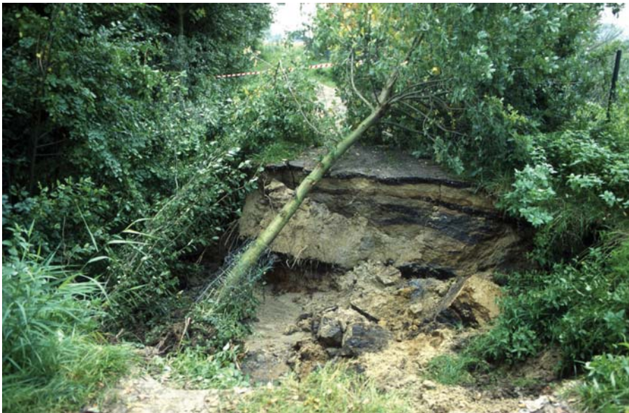
Abb. 5-8. Durch Biberröhre gebrochener Damm eines Klärbeckens.
