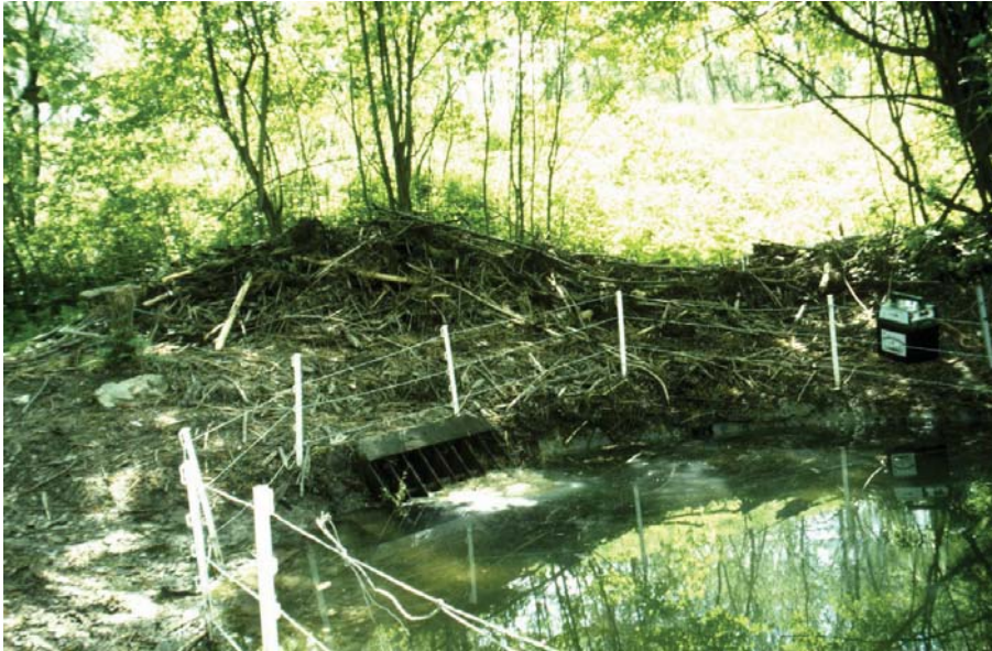
Abb. 8. Elektrozaun zum Schutz eines Rohrdurchlasses vor Verbau durch Biber.
