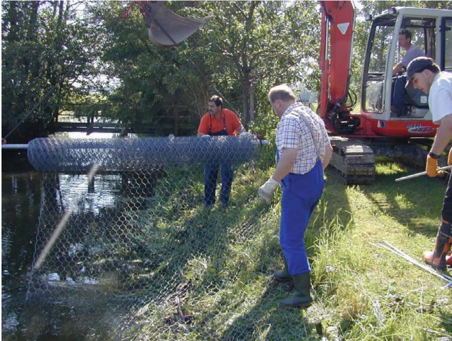
Abb. 6-11. Sicherung eines Ufers gegen Unterminierung mittels Drahtgitter.
