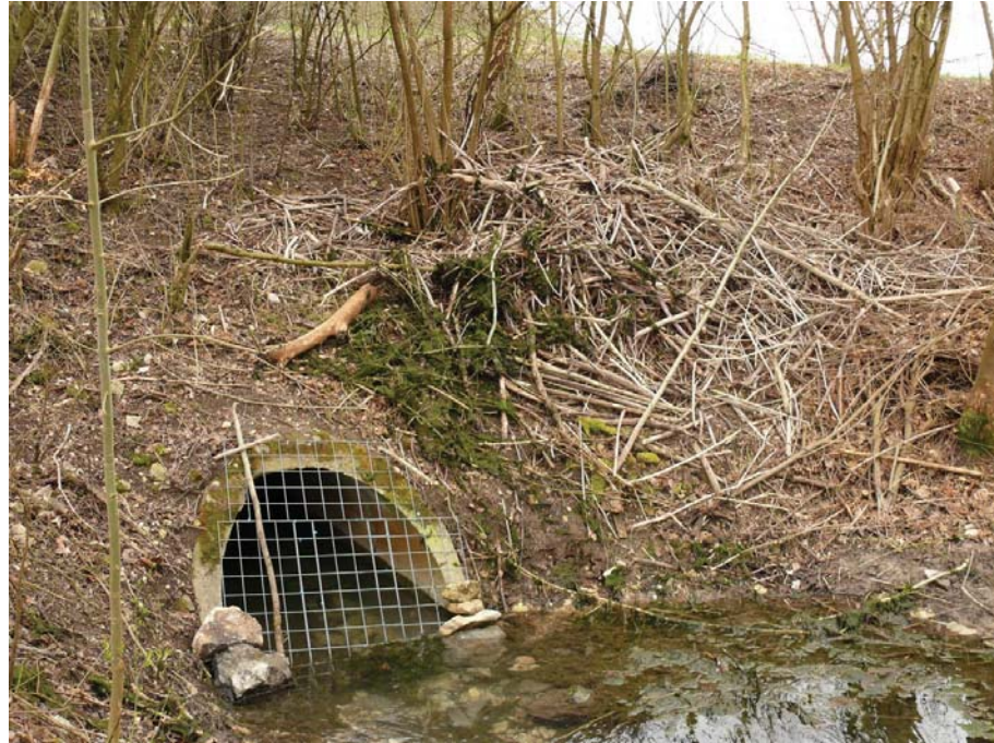
Abb. 6-10. Einfacher Schutz eines Rohrdurchlasses mit aufgelegtem Gitter. Rechts im Bild das über längere Zeit aus dem Rohr entfernte Material.
