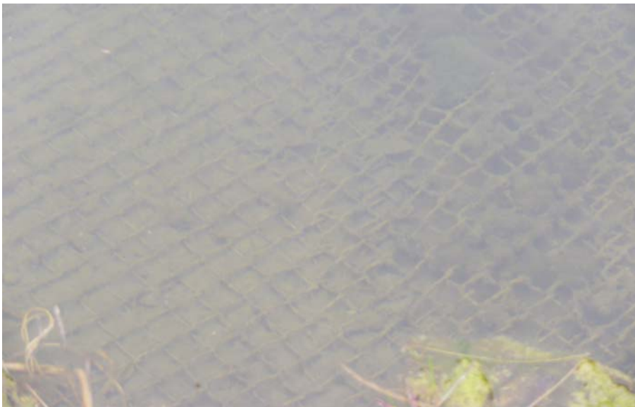
Abb. 18. Im Dauerwasserbereich des Flutkanals ist das Geflecht ohne Abdeckung verlegt und schlammte mit der Zeit ein.
