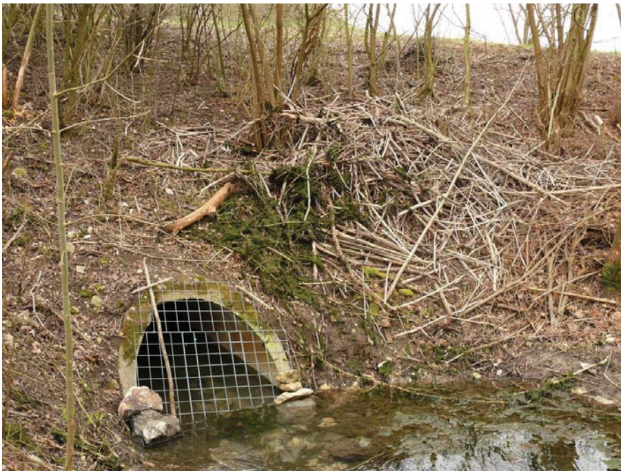
Abb. 1. Einfacher Schutz eines Rohrdurchlasses mit aufgelegtem Gitter. Rechts im Bild das über längere Zeit aus dem Rohr entfernte Material.
